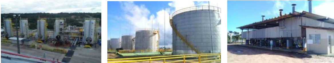
Figura 7 - Vasos tratadores e tanque de lavagem de petróleo, caldeira/gerador de vapor
