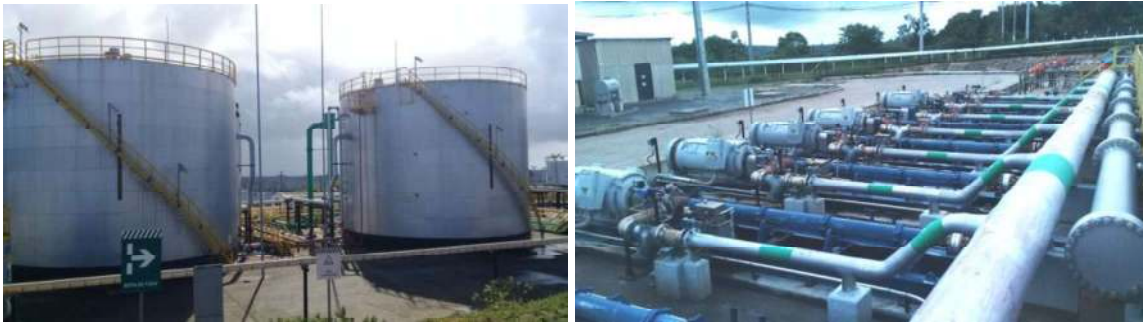
Figura 10 - Tanques de flotação e Bombas BCPH de injeção de água produzida
