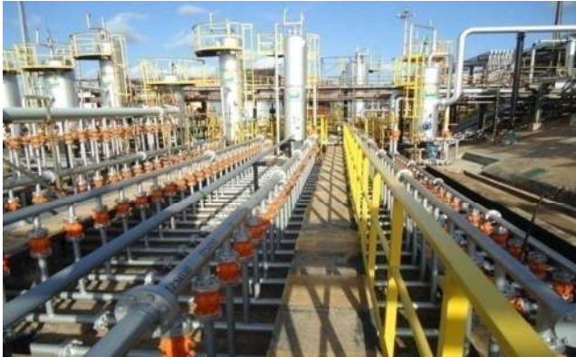
Figura 5 - Manifold - linhas/dutos de escoamento e válvulas de bloqueio
