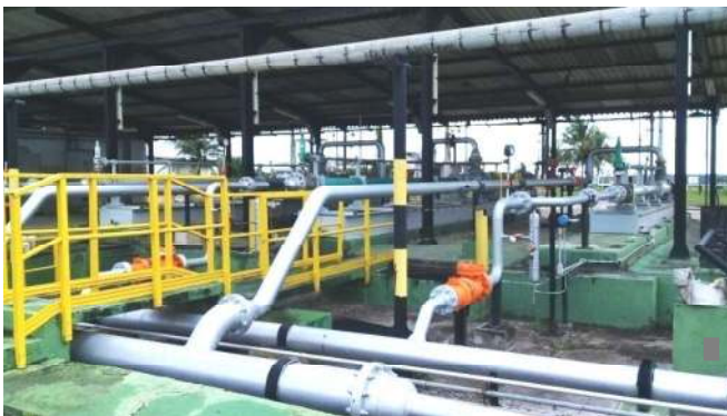
Figura 9 - Bombas BCPH de transferência de petróleo especificado
